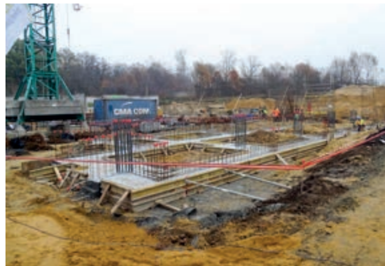
Tu powstaje hala sportowo-widowiskowa w Ziębicach, największa inwestycja w historii tego samorządu
